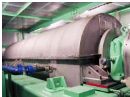
<西部スラッジセンター・脱水施設> 遠心脱水機
