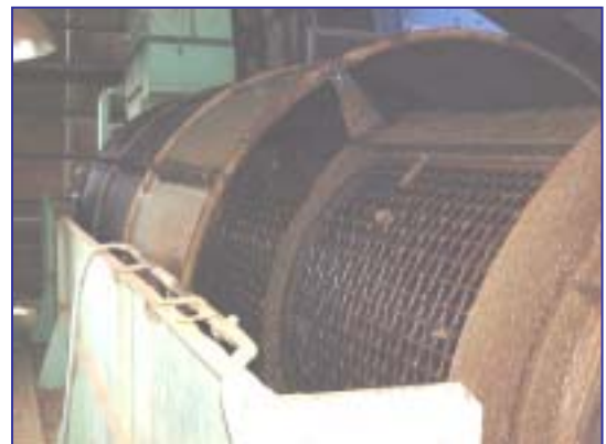
<中沼路盤材リサイクルプラント> トロンメル(分離機)
