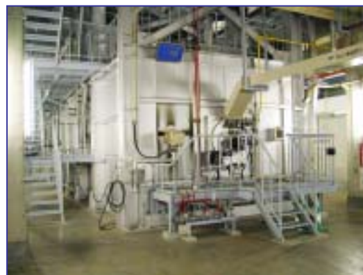
<西部スラッジセンター・焼却施設> 階段式ストーカ炉
