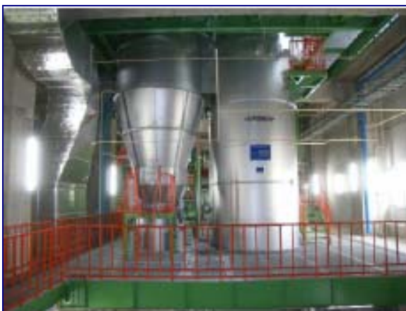
<東部スラッジセンター・焼却施設> 循環式流動焼却炉
