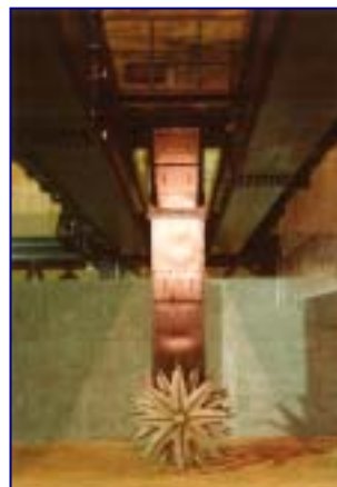
<厚別コンポスト工場> 切返機（一次発酵槽）
