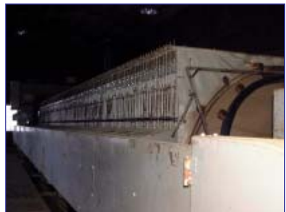
<中沼路盤材リサイクルプラント> フィルタープレス(加圧脱水機)
