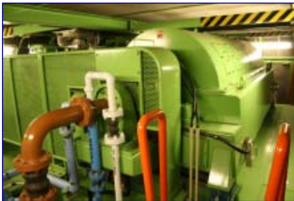
<東部スラッジセンター・脱水施設> 遠心脱水機
